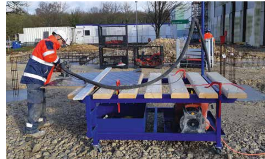
Établi « 5S » sur site.
