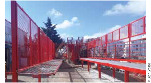
Quai de déchargement mobile sécurisé sur 3 faces.
