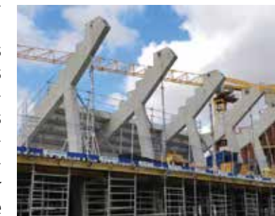
Réalisation de poutres crémaillères coulées en place à l'aide de banches grande hauteur.
