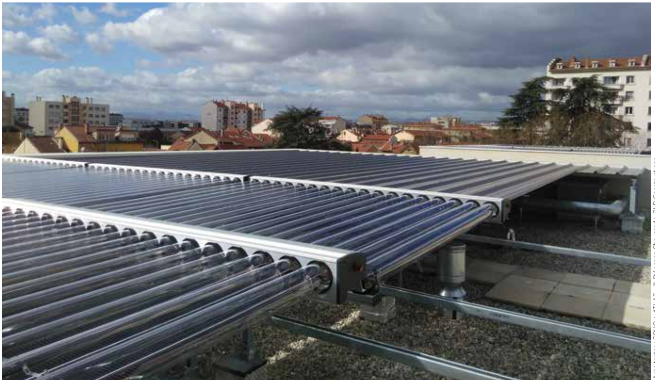
À Lyon, des panneaux solaires pour l'eau chaude sanitaire de logements qui bénéficient du label BBC Effinergie.
